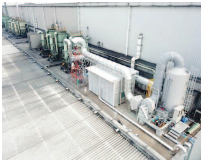
ระบบบำบัดกลิ่น Wet Scrubber+ Cold Plasma Odor treatment system Wet Scrubber+ Cold Plasma
