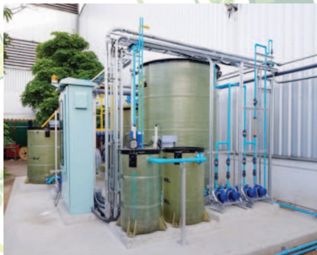
ระบบบำบัดน้ำเสียรีไซเคิล Water recycle treatment system
